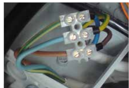
Abb. 7: Hier wurden N- und PE vertauscht
