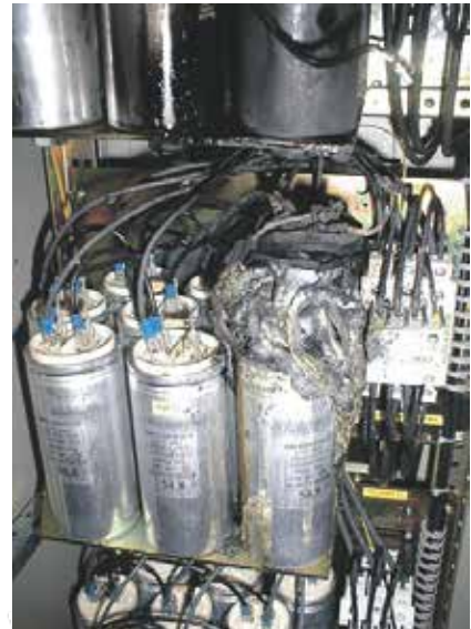
Abb.: Zerstörte Kondensatoren durch Oberschwingungen
