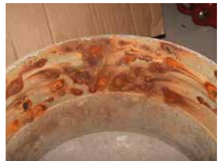
Abb.: Korrosionen von Rohrleitungen
